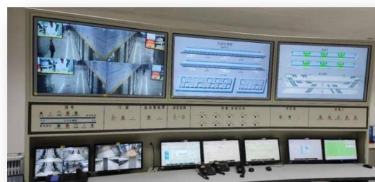
轨交综合 (消防+视频) 监控
